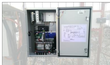
Шкаф ПТК ССПИ ЭНТЕК
