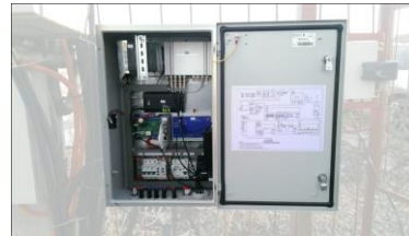
Шкаф ПТК ССПИ ЭНТЕК
